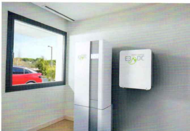
Die TÜV-zertifizierte Kombilösung „Edison V2H“ für das bidirektionale Laden kommt dabei von E3DC – sie umfasst Hauskraftwerk, Spannungswandler und DC-Ladestation. ( www.e3dc.com )
